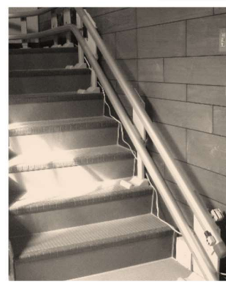
昇降機も設置 しました。
